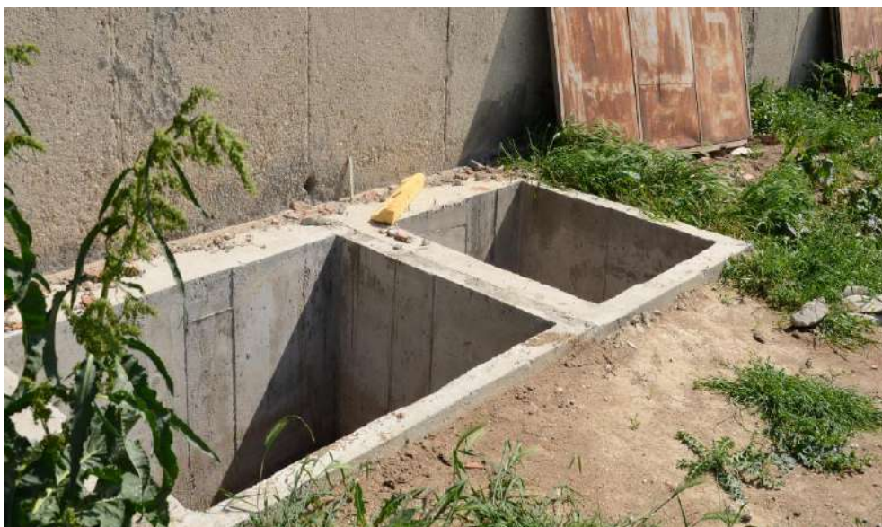
Резервоари за отпадна вода
